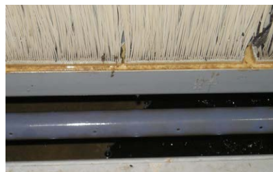
Figura 6.12 Tubería de la parrilla de aireación del sistema Zenon
