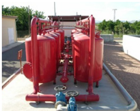
Figura 5.6 Filtros de arena a presión (Iglesias, R.)
