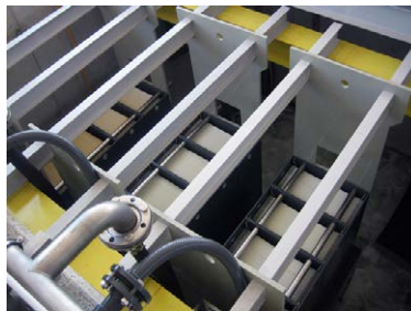
Figura 6.44 Tanque de membranas con conexiones de permeado y aire de limpieza
