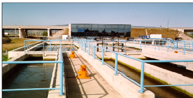
Figura 5.1 Tratamiento de regeneración mediante físico-químico, decantación lamelar, filtración sobre arena y desinfección por hipoclorito, Vitoria (Iglesias, R)
