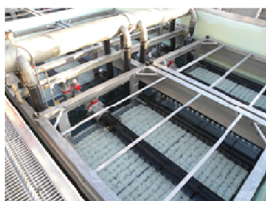
Figura 6.21 Tanque de membranas con bastidores PSH de PURON.
