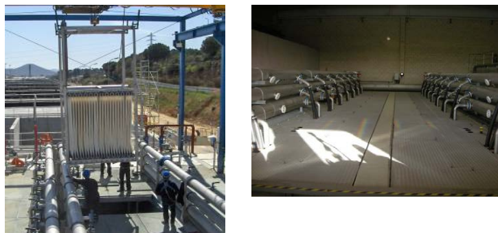
Figura 6.9 Izquierda: Tanque de membranas con un bastidor extraído. Derecha: Tanque de membranas con conexiones de permeado y aire de limpieza.
