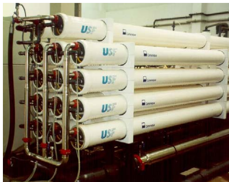
Figura 5.21 Ósmosis Inversa instalado, Gran Canaria (Iglesias R.)
