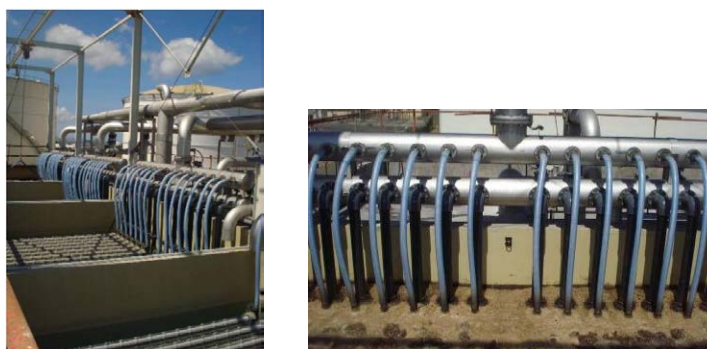
Figura 6.15. Izquierda: Tanque de membranas con bastidores. Derecha: Detalle de conexiones de permeado y aire de limpieza
