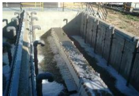
Figura 5.8 Filtros de lecho pulsante en funcionamiento (Iglesias, R.)
