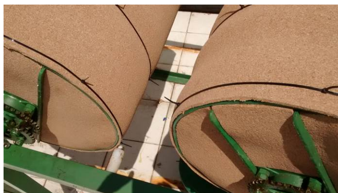
Figura 10: Reatores com duas camadas de cortiça para isolamento térmico.
