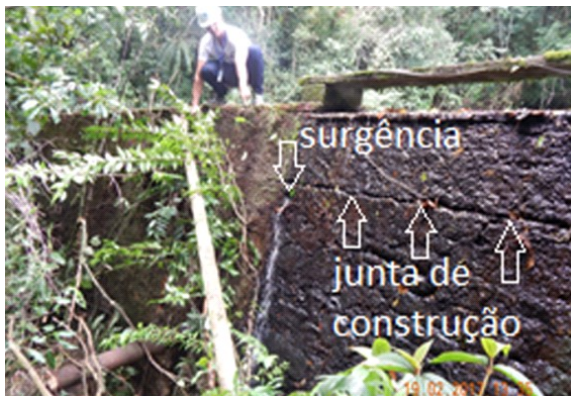
Foto 10: Barragem do Mato do Sistema Aldeia da Serra em destaque paramento de jusante.
