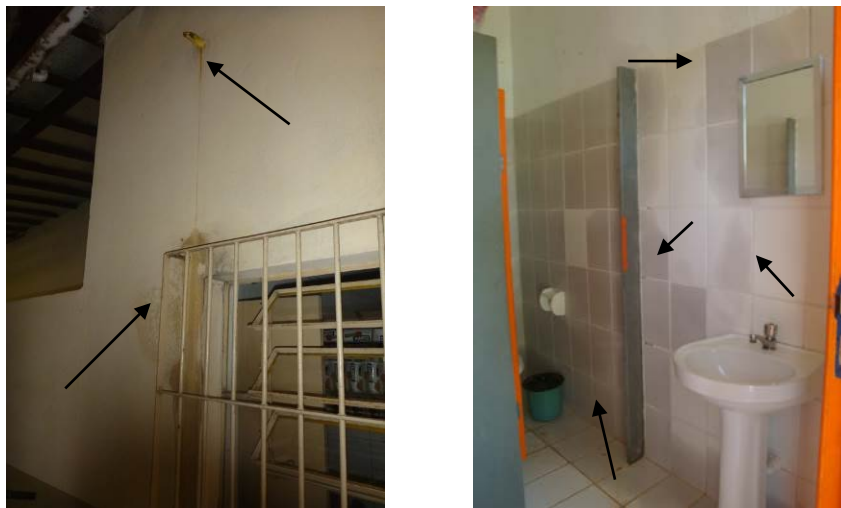
Figura 9 – Efeitos do vazamento de reservatórios sobre lajes
