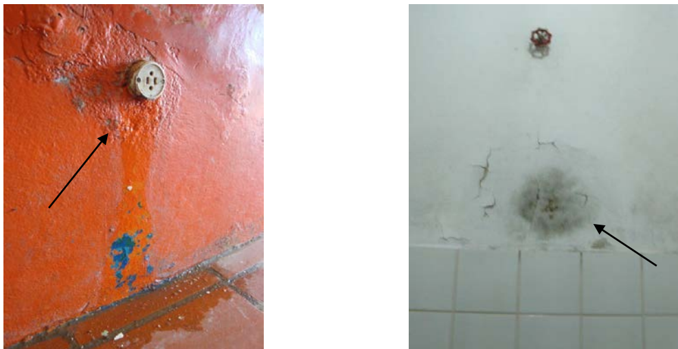
Figura 11 – Indícios de vazamentos por fissura ou ruptura de tubulações embutidas
