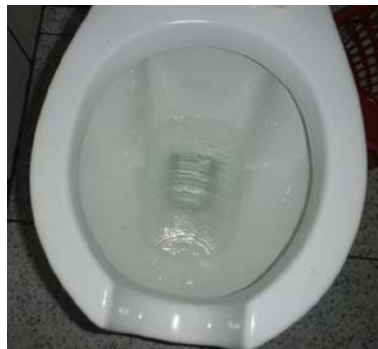
Figura 8 – Exemplo de falta de estanqueidade nos aparelhos de descarga de bacias sanitárias
