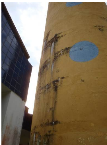
Figura 10 – Reservatório não estanque
