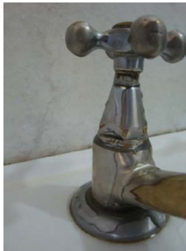
Figura 7 – Exemplo de torneira com falta de estanqueidade na região do castelo
