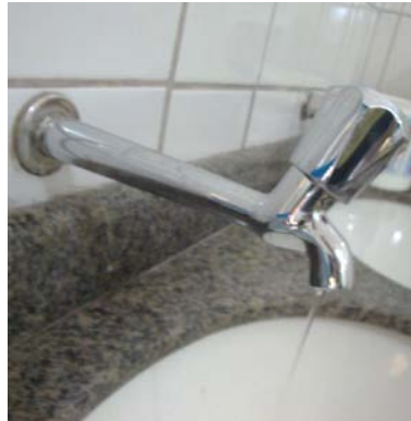
Figura 6 – Exemplo de torneira com falta de estanqueidade no elemento de vedação
