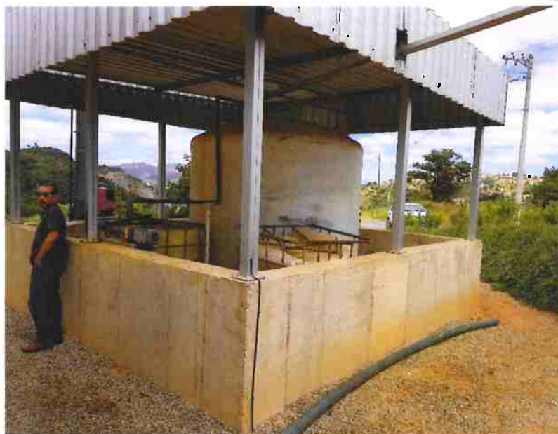
Foto 7 – Tanque de ácido sulfúrico, utilizado no processo de tratamento.
