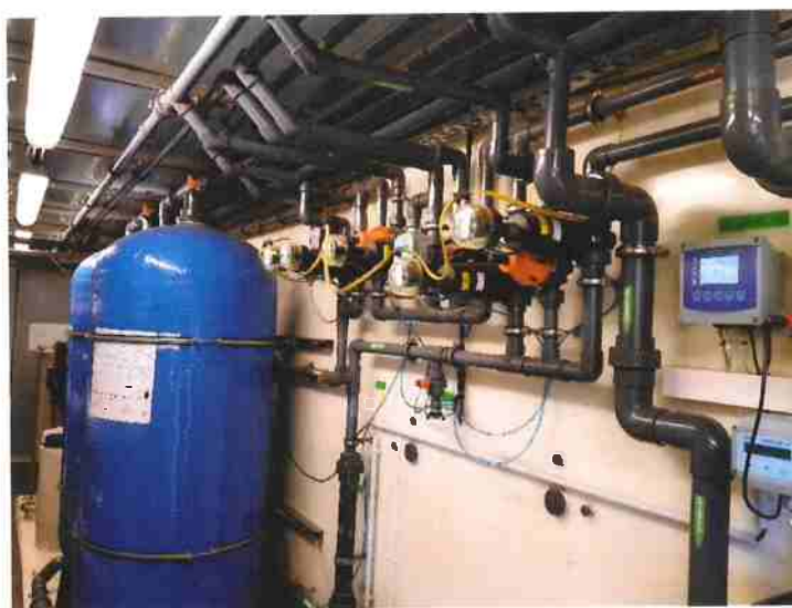
Foto 4 – Visão interna do sistema de tratamento.
