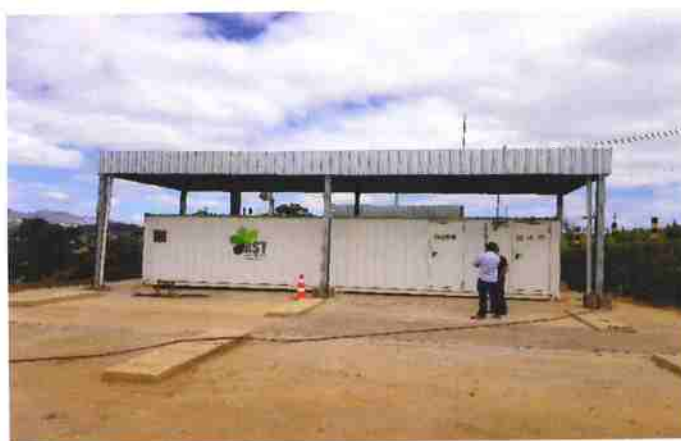
Foto 3 – Unidade Modular de tratamento de chorume por Osmose Reversa.
