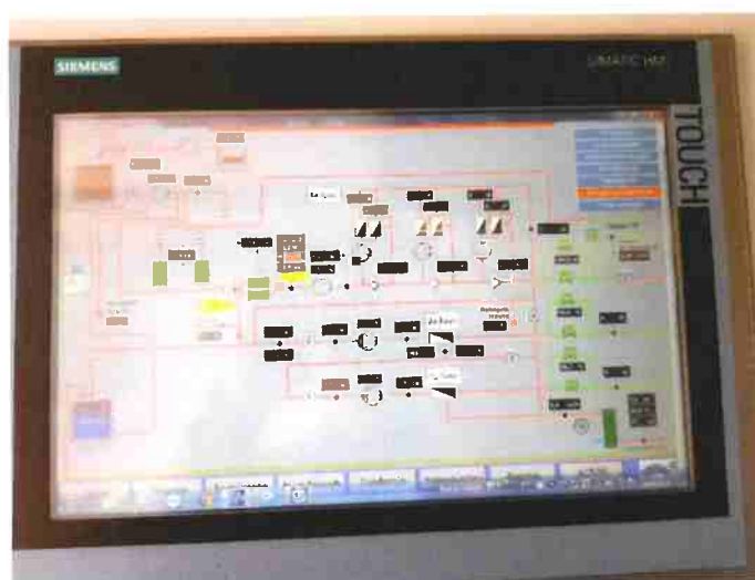
Foto 6 – Painel do Supervisório da estação de tratamento.
