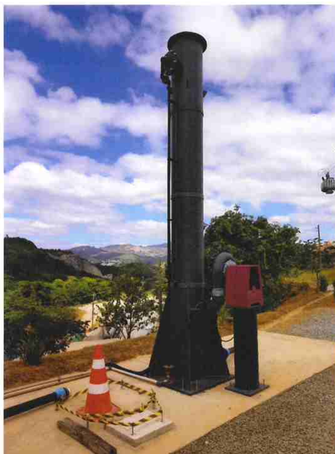
Foto 8 – Torre de lavagem de gases para remoção de amônia.
