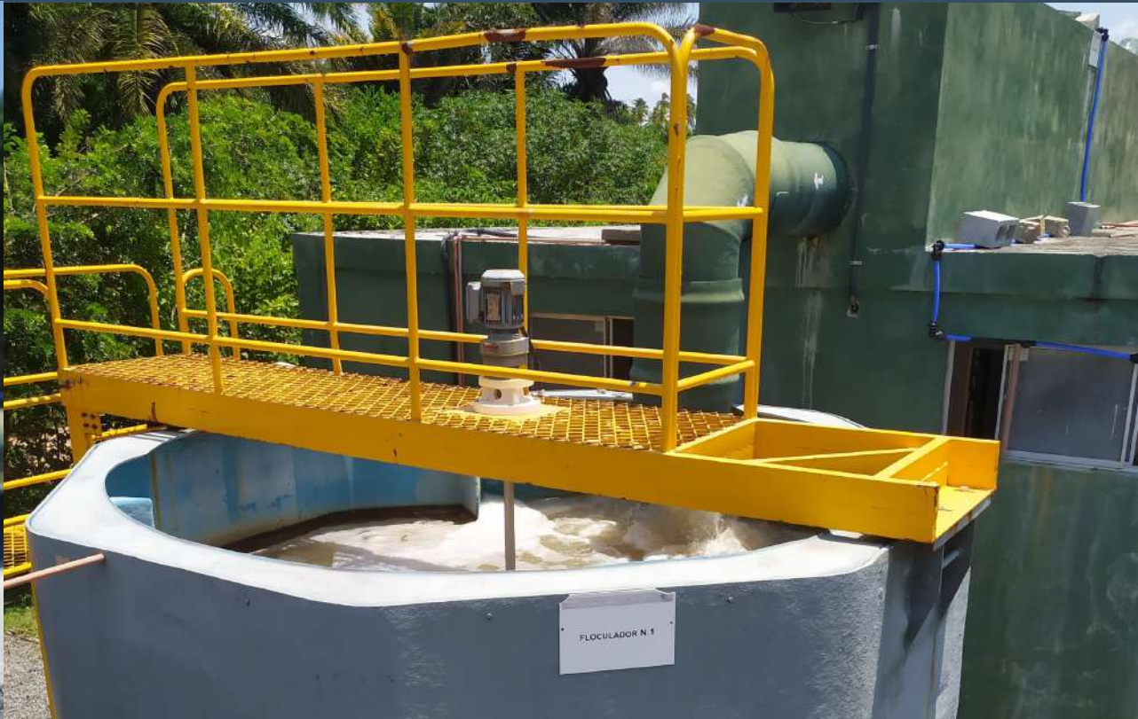
Com vazão média sazonal de 35 L/s, a ETE Iberostar fornece água de reúso paraa abastecimento das lagoas que irrigam os campos de golfe do Complexo Hoteleiro do Iberostar
