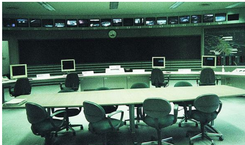
Figura 1: Sala de Controle do projeto G-Cans, em Saitama, Japão
