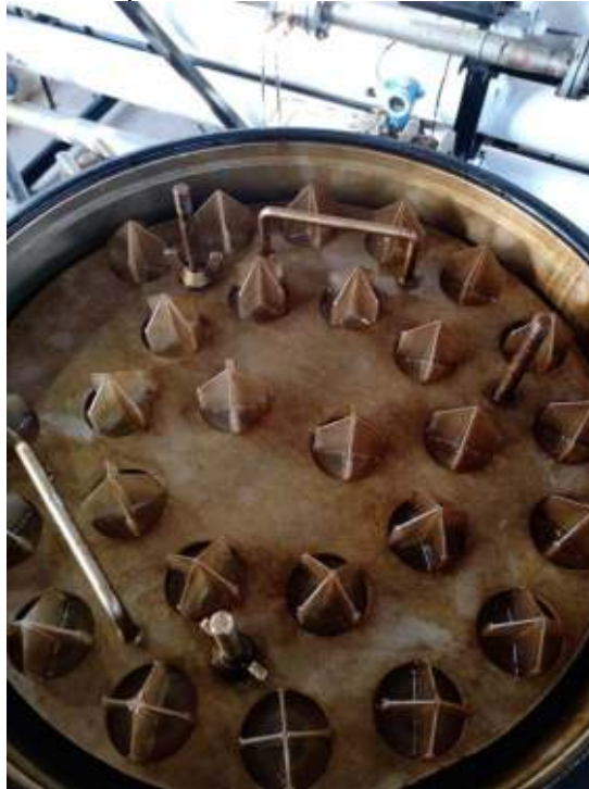
Figura 14 – Filtro polidor do sistema de osmose reversa 2.
