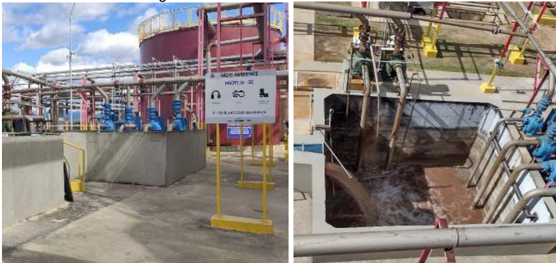
Figura 17 - Elevatória de entrada ETEI
