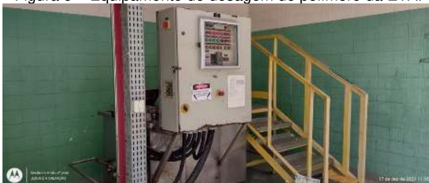
Figura 5 – Equipamento de dosagem de polímero da ETA.
