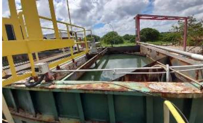
Figura 4 – Câmara de floculação da ETA convencional.
