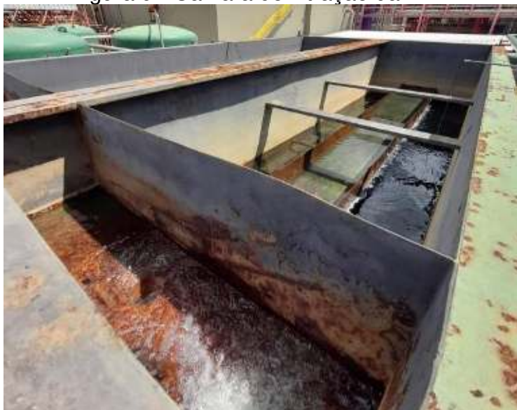
Figura 9 - Câmara de filtração da ETA.
