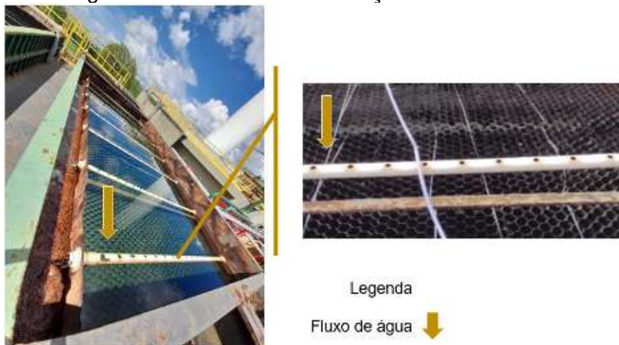
Figura 7 – Módulos de decantação do decantador.
