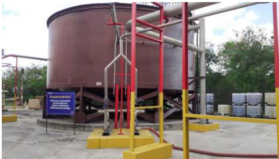
Figura 25 – Adensador de lodo.
