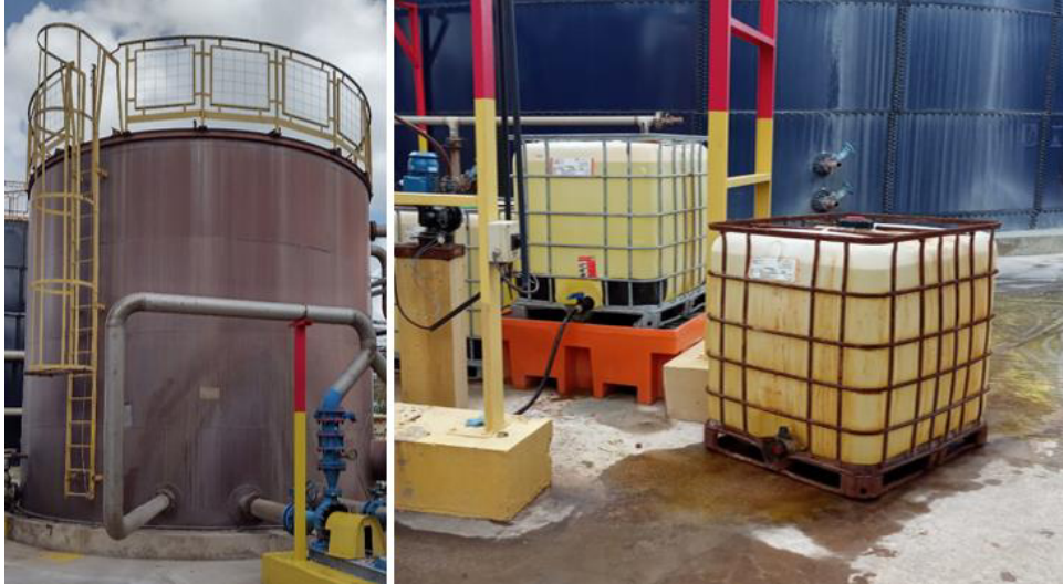
Figura 19 – Tanque de condicionamento e dosagem de ácido.
