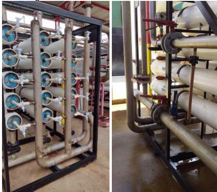
Figura 11 – Banco de osmose reversa 1.
