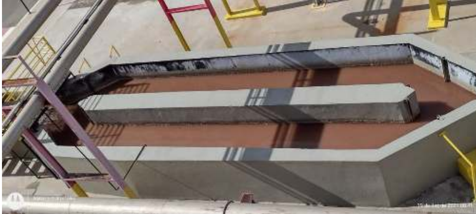
Figura 16 – Caixa de areia do recebimento de efluente.
