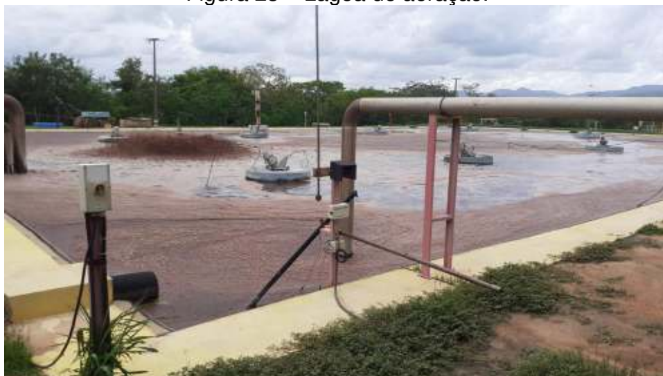
Figura 23 – Lagoa de aeração.
