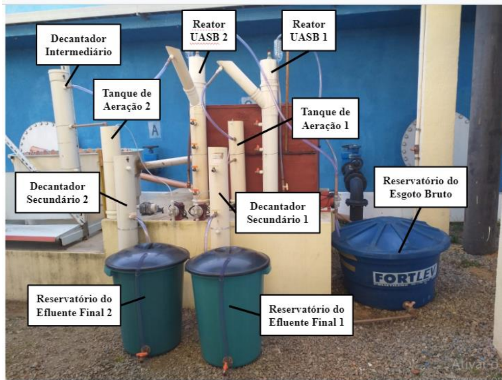
Figura 4 - Sistema de Tratamento do experimento, já instalado na estação
