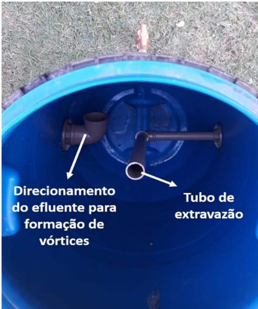
Figura 7 - Detalhes interiores do decantador (S3).
