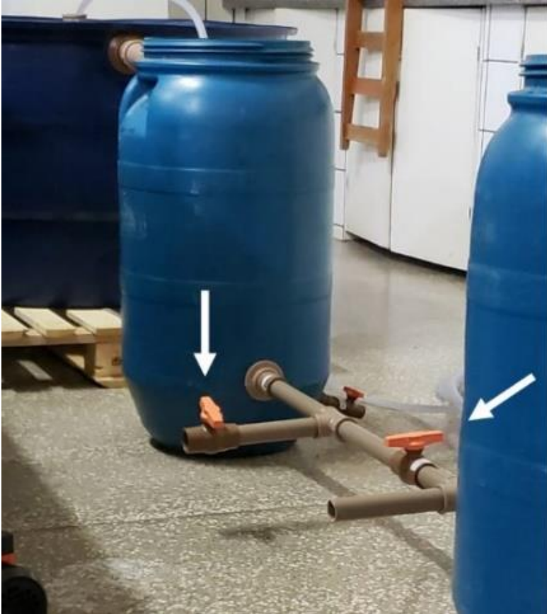
Figura 6 - Registros para limpeza (TPA) e manutenção. Fonte: Autor.
