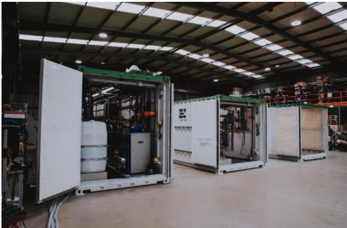
Figura 7 - Estação de tratamento de chorume.
