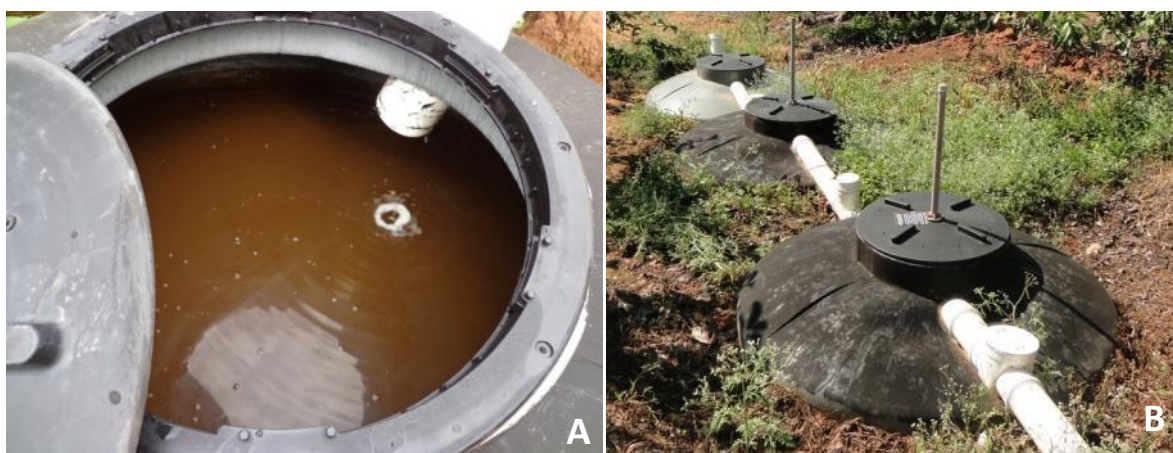
Figura 6.5. A) Detalhe da tampa rosqueável na caixa de polietileno de 1.000L. B) Sistema implantado em Pedra Branca, mostrando que o corpo das caixas fica parcialmente enterrado no solo.
