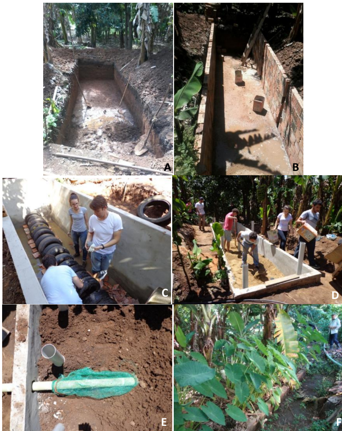
Figura 6.6. Etapas da construção da Bacia de evapotranspiração implantada em Pedra Branca, Campinas/SP. A) Solo escavado manualmente. B) Construção da caixa em alvenaria. C) Formação da câmara de pneus. D) Preenchimento da 3ª camada (areia grossa). E) Instalação do dreno na camada de terra. F) Sistema em operação, com taiobas e bananeiras produzindo e solo coberto com palhada seca.
