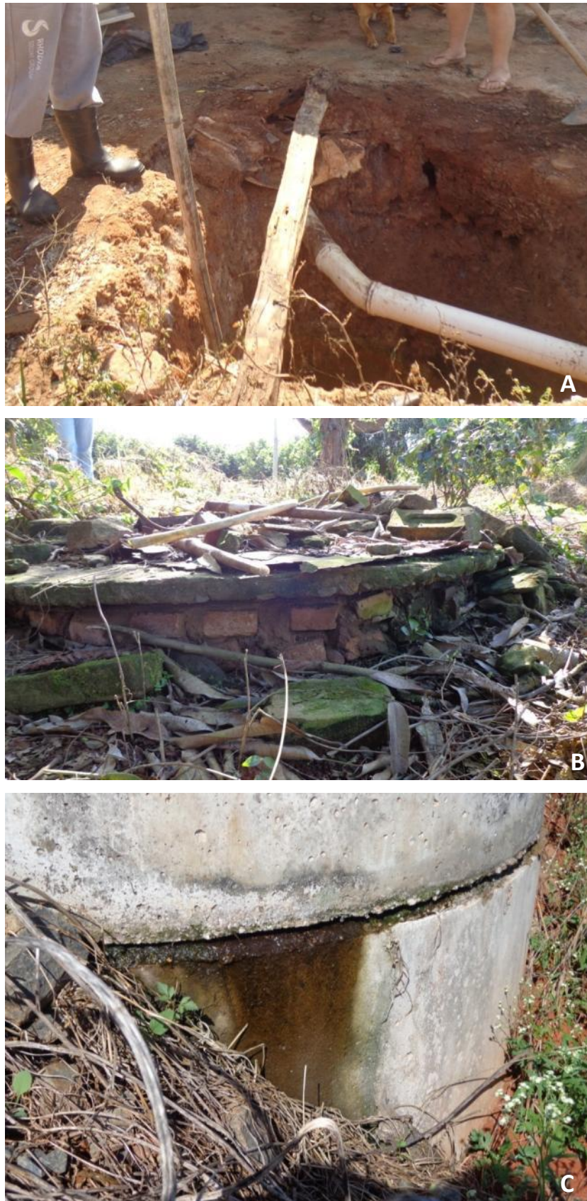
Figura 4.11. Formas de construção das fossas rudimentares de Pedra Branca. A) Sem revestimento (apenas escavação no solo). B) Tijolamento. C) Anel de concreto pré-moldado (na foto é aparente um vazamento na estrutura).
