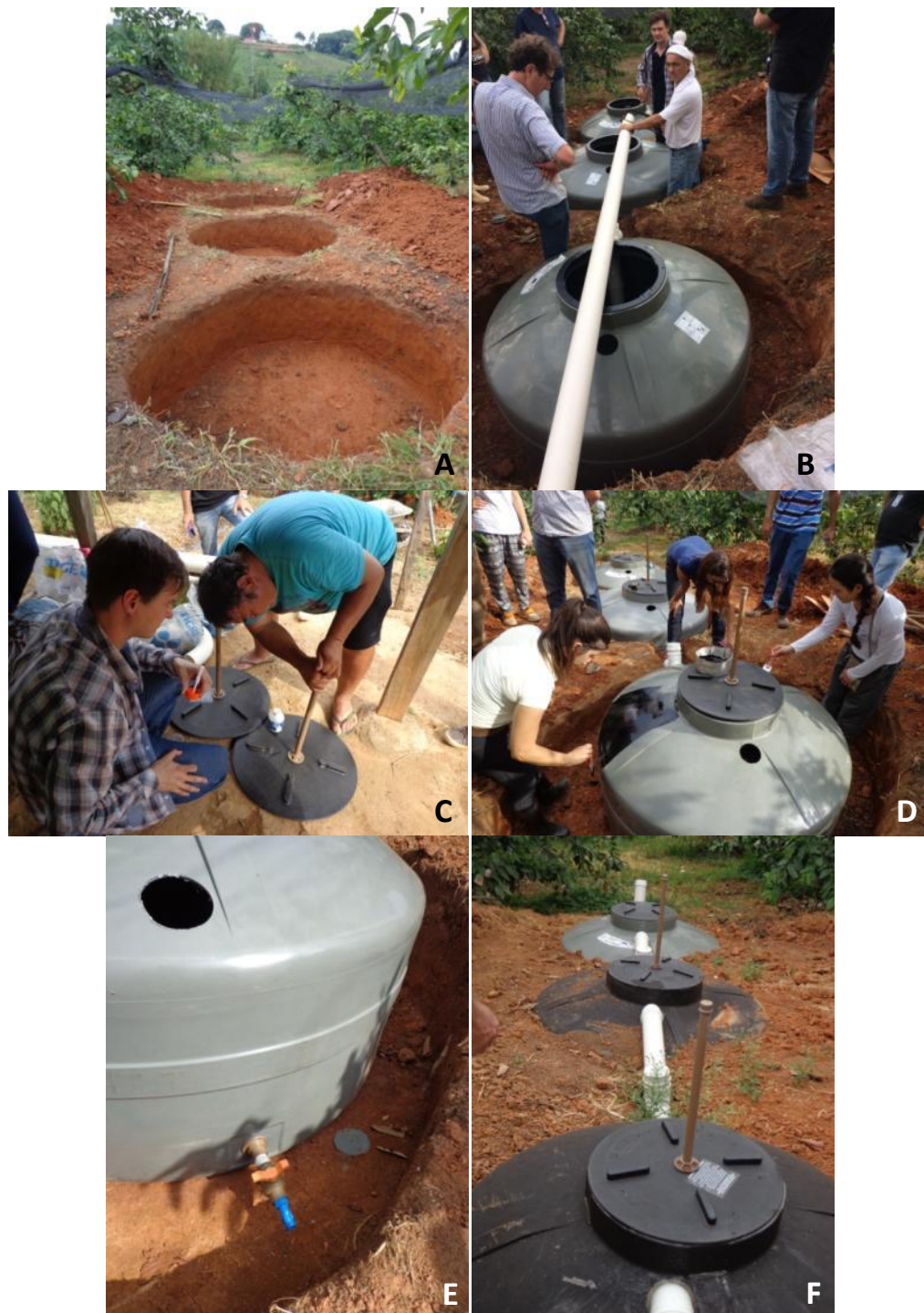
Figura 6.2. Imagens da construção da FSB implantada em Pedra Branca. A) Solo escavado e compactado manualmente. B) Instalação das caixas d'água e tubulação. C) Fabricação das válvulas de alívio de gases. D) Pintura das tampas. E) Detalhe do registro para remoção do efluente tratado. F) Vista geral do sistema pronto e em funcionamento.
