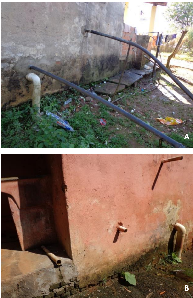
Figura 4.4. Imagens da segregação do esgoto em domicílios rurais de Pedra Branca. A) Águas cinzas (tubo flexível preto) e águas de vaso sanitário (tubulação de PVC branca). B) Águas cinzas do tanque, chuveiro e pia do banheiro (tubos de PVC branco abertos e mais finos) e águas de vaso sanitário (tubulação PVC 100 mm fechada).
