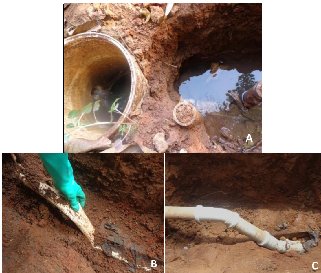
Figura 8.5. A) Vazamento do efluente na entrada da vala de bambu. B) Tubulação de saída da caixa sifonada danificada. C) Mesma tubulação reparada.
