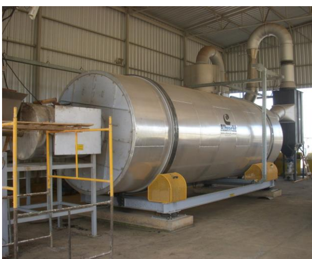
Figura 4-26: Vista geral do secador térmico de lodo instalado na ETE Montes Claros
