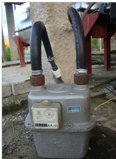
Figura 7-16: Medidor de vazão de biogás
