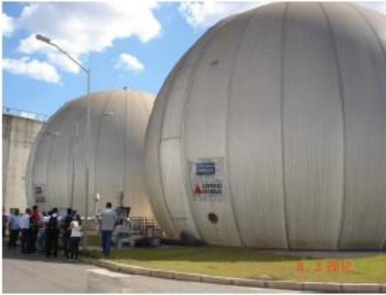
Figura 4-33: Gasômetros para armazenamento de biogás
