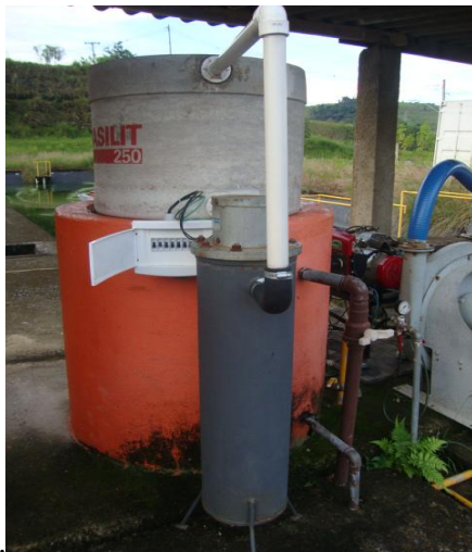
Figura 7-8: Banco de resistência elétrica
