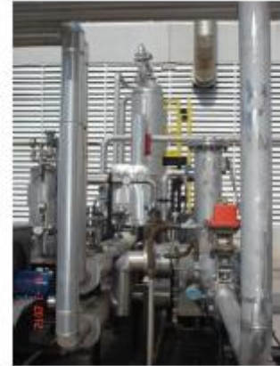
Figura 4-34: Sistema de purificação do biogás
