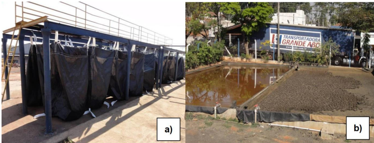
Figura 39 – a) Disposição dos bags verticais e abertos, sendo utilizados para desaguamento do lodo na ETA. Fonte: Pessoa (2007) e b) Leitões de secagem final.
