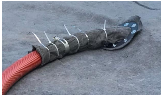
Figura 44 – Bocal de enchimento com flange metálica.
