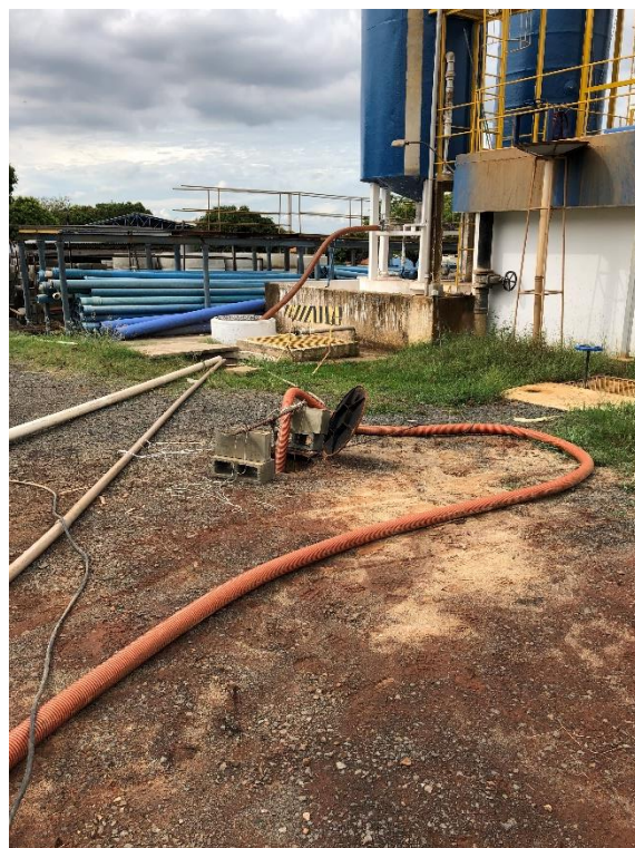
Tubulação de sucção saindo do poço
