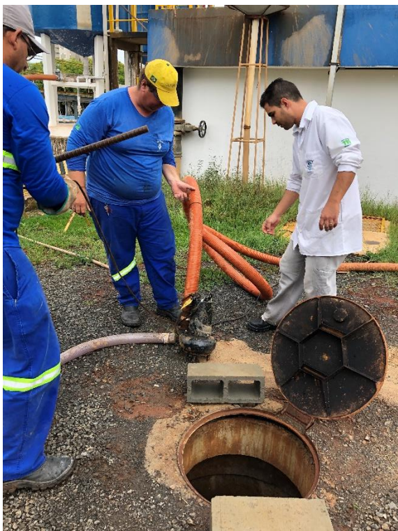
Após o fechamento da tubulação de saída do poço, ocorreu a instalação da bomba
