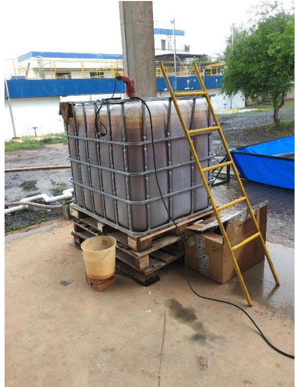
Tanque de preparação do polímero (após o preparo, era inserida bomba dosadora para injetar na tubulação)
