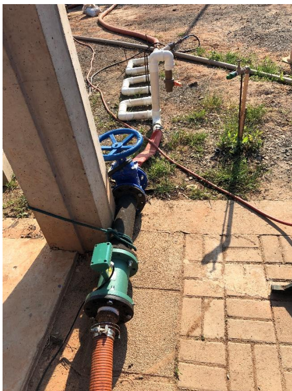
Na sequência, no sentido do poço para o tubo geotêxtil: a entrada de polímero, a chicana, o registro e o medidor de vazão
