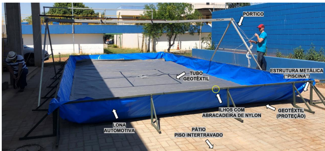
Figura 49 – Infraestrutura para monitoramento do tubo geotêxtil preenchido com lodo com polímero (apesar de não ser possível visualizar na imagem, o GCD encontra-se instalado abaixo no tubo geotêxtil).
