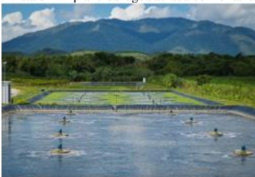
Figura 3: Vista em 1º plano da lagoa aerada de montante da ETE.
