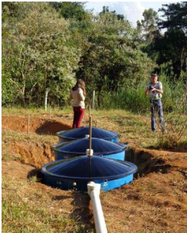
Figura 4: FSB instalada em Holambra.
