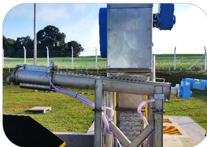
HELICOIDAL COM COMPACTADOR E LAVADOR
