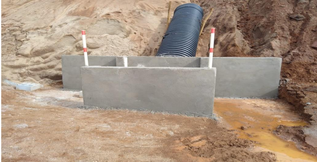
Figura 6: Tubo e ala no pé do talude
