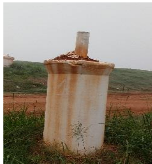
Figura 15. Dreno de gás
