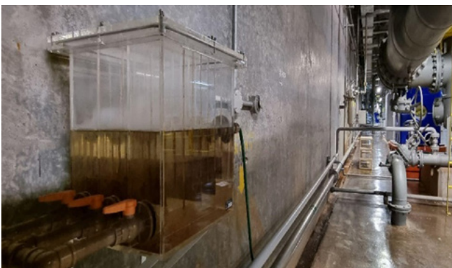
BioBox instalado no sistema de resfriamento da Usina Hidrelétrica Governador José Richa.
