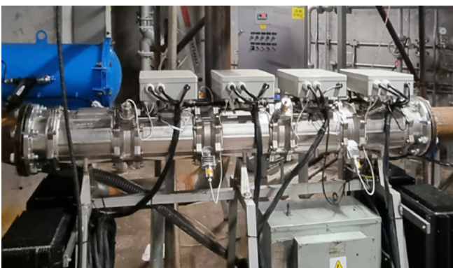
Sistema HOD UV composto por um filtro e pelo sistema HOD UV, instalado no sistema de resfriamento da unidade geradora 4 da Usina Hidrelétrica Governador José Richa.
