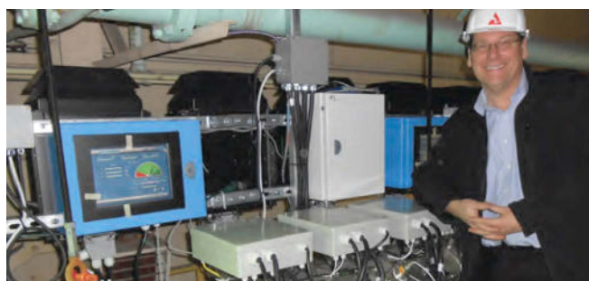
Instalação de decloração HOD UV da Atlantium em Plant Bowen, Geórgia, EUA
