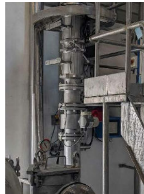
Instalação do sistema vertical Atlantium RZ163-11 em 2014 com vazão de 250 gpm
