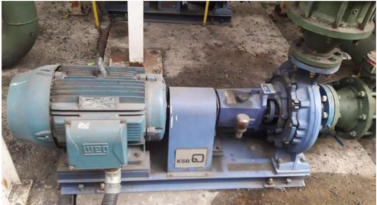
Figura 4.10 - Conjunto Montado da Bomba Hidráulica (KSB) e do Motor Elétrico (WEG)
