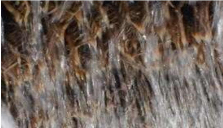
Figura 3.11 - Crescimento de Microrganismos em Torre de Resfriamento.
