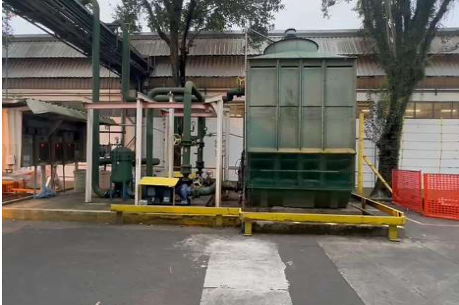
Figura 4.1 - Torre de Resfriamento (Planta 03)
