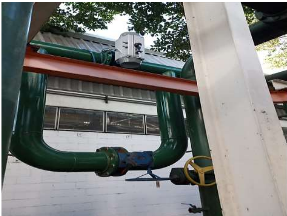
Figura 5.6 - Implementação da Válvula de By-pass e da Válvula Eletropneumática (Vista Lateral)
