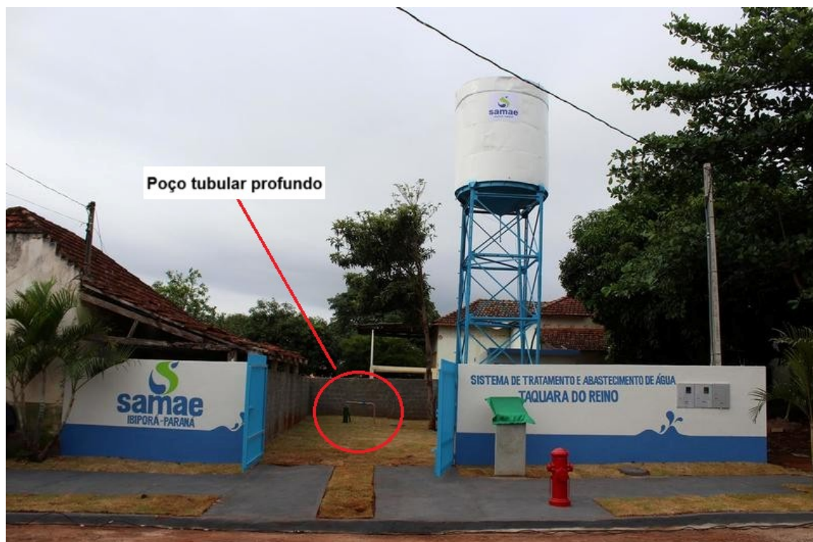
Figura 12 - Unidade Descentralizada de Tratamento e Distribuição de água para Abastecimento Público Taquara do Reino
